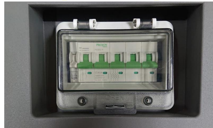
Leitungsschutzschalter in der BCU
